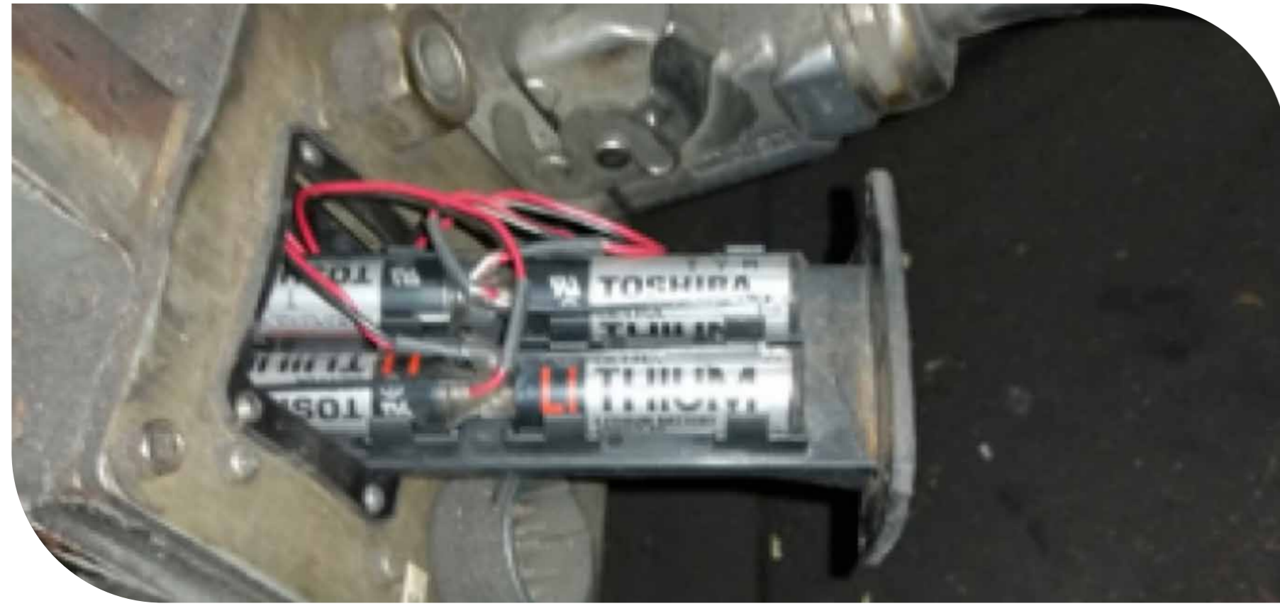
Cambio de baterías
