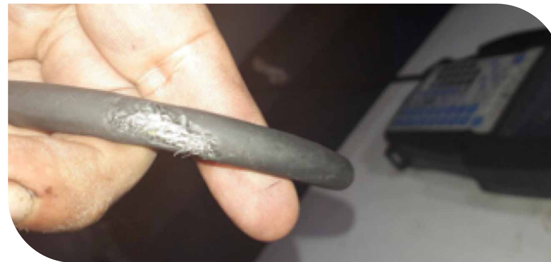
Revisión de conexiones eléctricas
